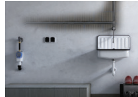
↑ VOORBEELD: ONGEBRUIKTE DODE LEIDINGEN
